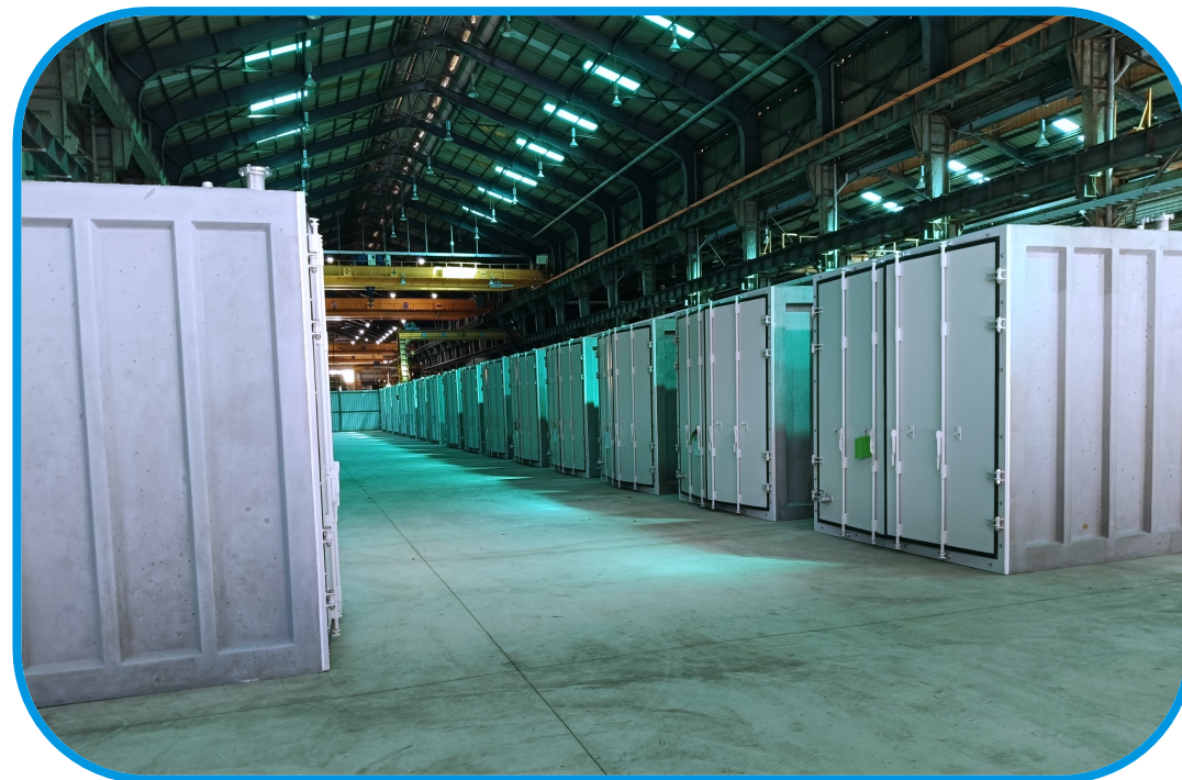
83MWh 櫃體出貨 鋰三元電芯 (Li-ion)
