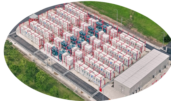
100MWh + 80MWh 櫃體出貨
