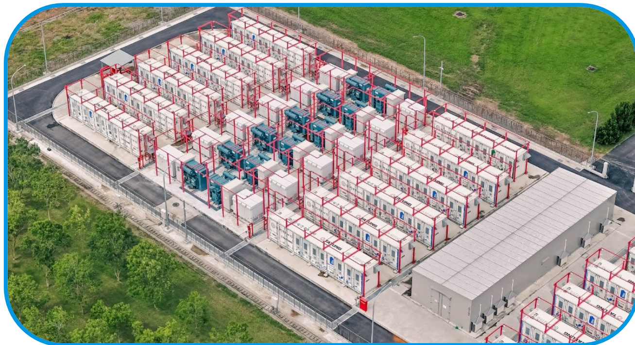
100MWh 櫃體出貨 鋰三元電芯 (Li-ion)
