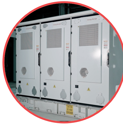
1.3MW/2.7MWh 鋰鐵電芯 (LFP)
